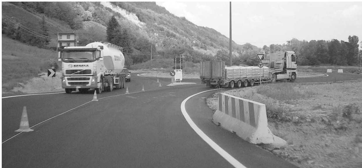
Un'immagine della nuova tangenziale di Lugagnano che dovrebbe eliminare il traffico veicolare pesante nel paese della Valdarda (foto Terzoni)
